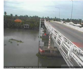
สะพานบุญรัตนประชาอนุวัฒน์ - อ.สามพราน จ.นครปฐม (ลุ่มน้ำท่าจีน)
