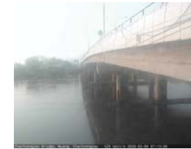
เขื่อนสะพานฉะเชิงเทรา - อ.เมือง จ.ฉะเชิงเทรา (ลุ่มน้ำบางปะกง)
