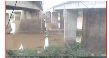
สถานีสะพานคชาดิวังค์ ต.ปากน้ำโพธิ์ อ.เมือง จ.นครสวรรค์ (ลุ่มน้ำเจ้าพระยา)
