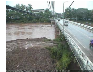
สะพานนครน่านพัฒนา อ.เมือง จ.น่าน (ลุ่มน้ำน่าน)
