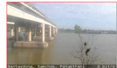
สถานีบ้านท้ายดง ต.บางกระเปาะ อ.สามโคก จ.ปทุมธานี (ลุ่มน้ำเจ้าพระยา)
