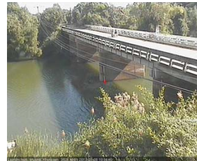
บ้านเหล่ากุ่ม - อ.เมือง จ.ขอนแก่น (ลุ่มน้ำชี)
