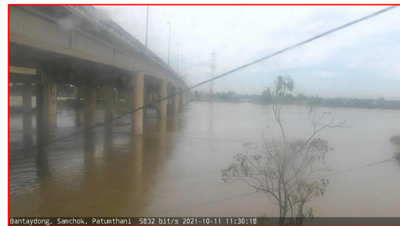
บ้านท้ายดง ต.บางกระบือ อ.สามโคก
