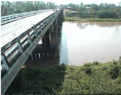
สะพานท่าเสา - อ.เมือง จ.อุตรดิตถ์ (ลุ่มน้ำ่าน)
