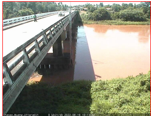
สะพานท่าเสา ต.ท่าเสา อ.เมือง จ.อุตรดิตถ์ (ลุ่มน้ำน่าน)
