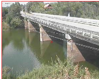
สถานีบ้านเหล่ากุ่มต.ดอนหัน อ.เมือง จ.ขอนแก่น(ลุ่มน้ำชี)
