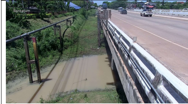
CCTV บ้านท่าตูม ต.หมู่น อ.เมืองอุดรธานี จ.อุดรธานี TC031506
