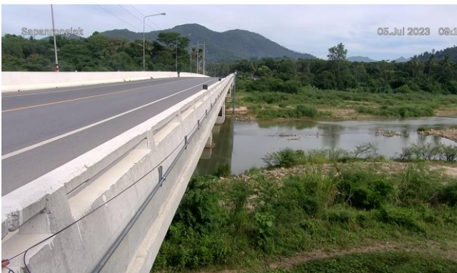
TC191802 : สะพานบ้านโรงเหล็ก ต.นบพิต อ.นบพิต จ.นครศรีธรรมราช
