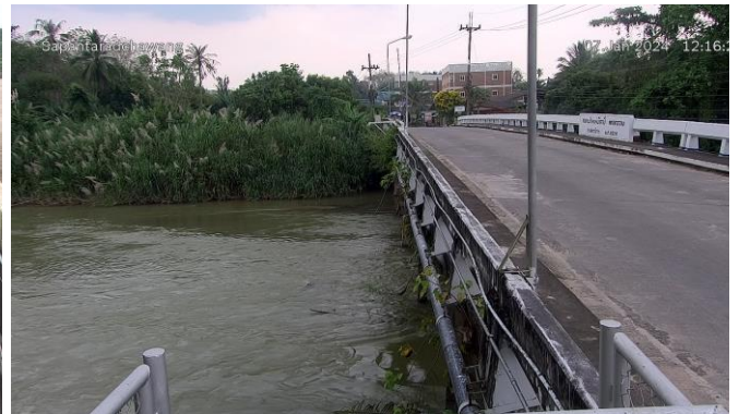
TC191001 : สะพานข้ามแม่น้ำตาปี ตลาดฉวาง ต.ฉวาง อ.ฉวาง จ.นครศรีธรรมราช
