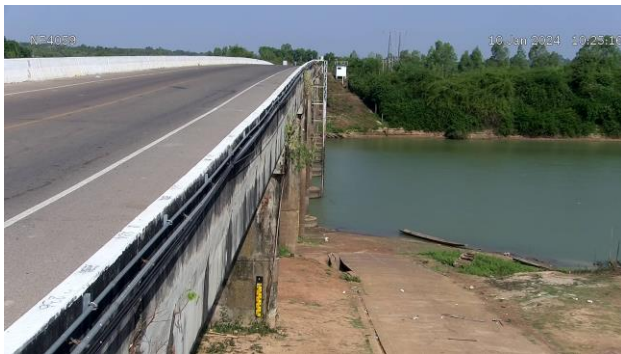
TC032705 : สะพาน นพ.4059 ต.ท่าบ่อสงคราม อ.ศรีสงคราม จ.นครพนม
