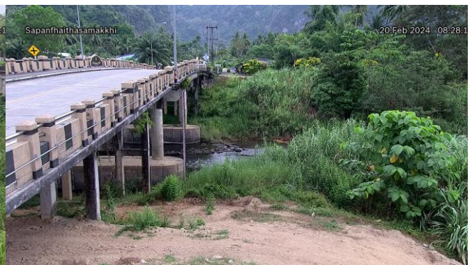
TC220510 : สะพานฝ่ายท่าสามัคคี ต.ถ้ำน้ำมุด อ.เมืองพังงา จ.พังงา
