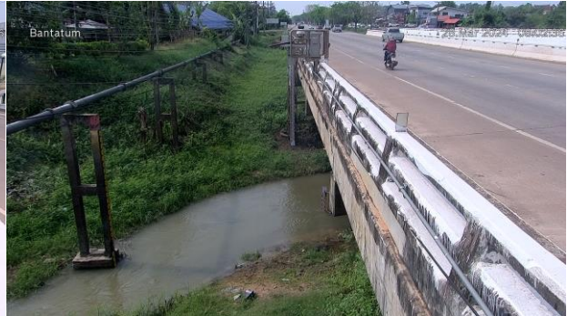
TC031506 : บ้านท่าตูม ต.หมู่มั่น อ.เมืองอุดรธานี จ.อุดรธานี
