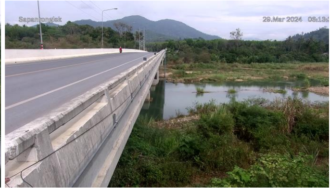
TC191802 : สะพานบ้านโรงเหล็ก ต.นบพิตำ อ.นบพิตำ จ.นครศรีธรรมราช
