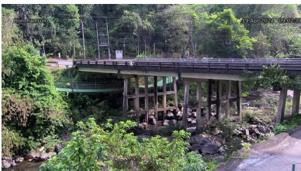
TC220303 : สะพานบ่อน้ำร้อน ต.บางรี อ.เมืองระนอง จ.ระนอง
