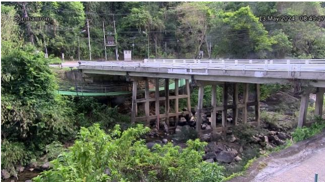
TC220303 : สะพานบ่อน้ำร้อน ต.บางรีน อ.เมืองระนอง จ.ระนอง
