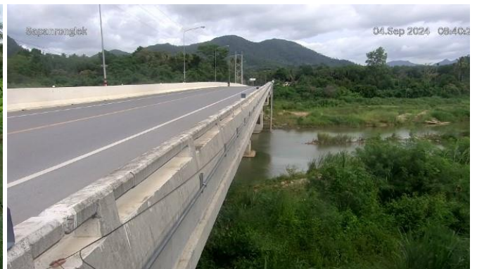
TC191802 : สะพานบ้านโรงเหล็ก ต.นบพิต อ.นบพิต จ.นครศรีธรรมราช
