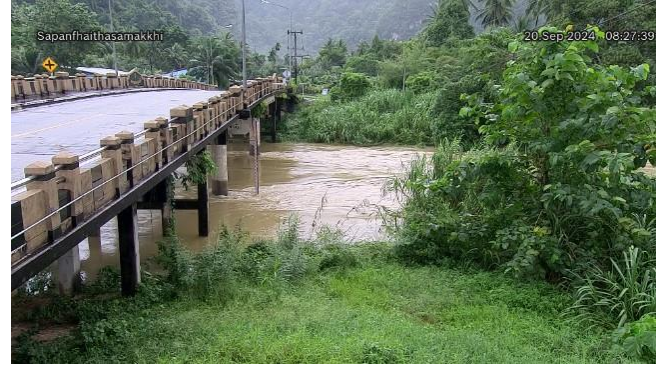
TC220510 : สะพานฝ่ายท่าสามัคคี ต.ถ้ำน้ำอ.เมืองพังงา จ.พังงา
