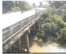
สถานีคลองตะหมัด - อ.ตะโหมด จ.พัทลุง (ลุ่มน้ำทะเลสาบสงขลา)
