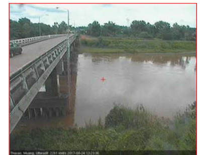
สถานีสะพานท่าเสา อ.เมือง จ.อุดรดิต์ (ลุ่มน่าน)
