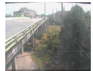
สะพานข้ามแม่น้ำท่าจีน ทางหลวง3365 อ.สามพราน จ.สุพรรณบุรี (ลุ่มน้ำท่าจีน)
