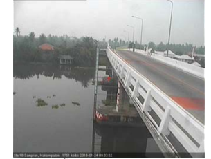
สะพานบุญรัตนประชาวุฒัน - อ.สามพราน จ.นครปฐม (ลุ่มน้ำท่าจีน)
