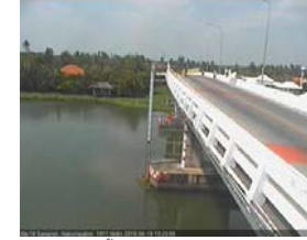
สะพานบุญรัตนประชาชนุวัฒน์ - อ.สามพราน จ.นครปฐม (ลุ่มน้ำท่าจีน)
