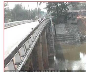
สถานีสะพานศรีสะเกษลือ อ.ศรีสะเกษลือ จ.สุโขทัย (ลุ่มน้ำยม)
