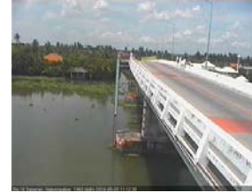
สะพานบุญรัตนประชาอนุวัฒน์ - อ.สามพราน จ.นครปฐม (ลุ่มน้ำท่าจีน)
