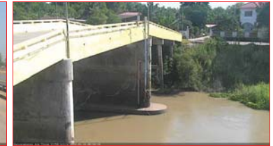
สถานีบ้านยางมณี ต.ดงครกซ์ อ.โพธิ์ทอง จ.อ่างทอง (ลุ่มน้ำเจ้าพระยา)
