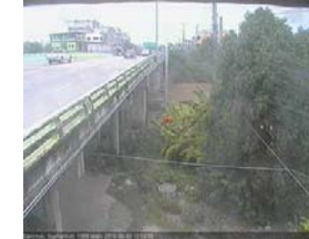
สะพานข้ามแม่น้ำท่าจีน ทางหลวง3365 อ.สามชุก จ.สุพรรณบุรี (ลุ่มน้ำท่าจีน)
