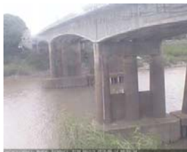
เชิงสะพานสิงห์บุรี - อ.เมือง จ.สิงห์บุรี (ลุ่มน้ำเจ้าพระยา)
