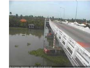
สะพานบุญรัตนประชาณุวัฒน์ - อ.สามพราน จ.นครปฐม (ลุ่มน้ำท่าจีน)
