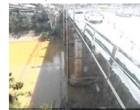
สถานีอุทกภาคอนล่าง - อ.หาดใหญ่ จ.สงขลา (ลุ่มน้ำทะเลสาบสงขลา)
