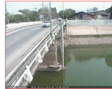
สถานีสะพานพระเมตตา อ.เมือง จ.สุโขทัย (ลุ่มน้ำยม)
