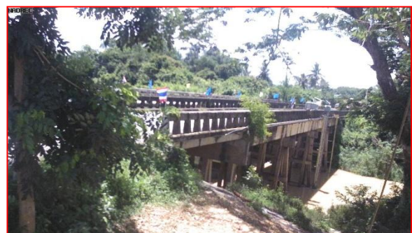
สถานีสะพานบ้านบางศาลา - ต.บ้านพรุ อ.หาดใหญ่ จ.สงขลา (ลุ่มน้ำทะเลสาบสงขลา)
